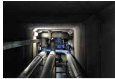
114_ Vàlvules del dipòsit d'aigües del parc de Can Werboom / Válvulas del depósito de aguas del parque de Can Werboom / Storage tank valves at the Can Werboom waterpark / Chambre de vannes du réservoir du parc de Can Werboom Premià de Mar Jorge Herrera
